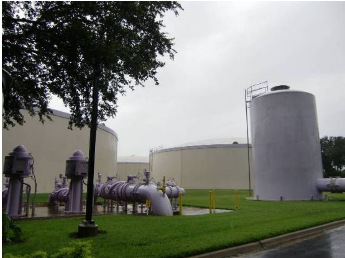
圖4-32 Water Conserv II的蓄水槽
