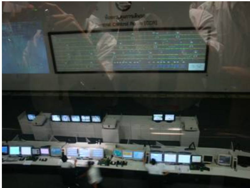
圖 26.地鐵監控中心之即時監控系統
