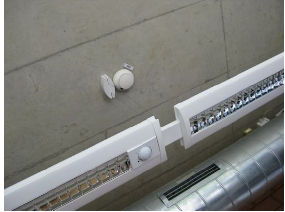
▶ 外露風管及可調整高度之照明設備
