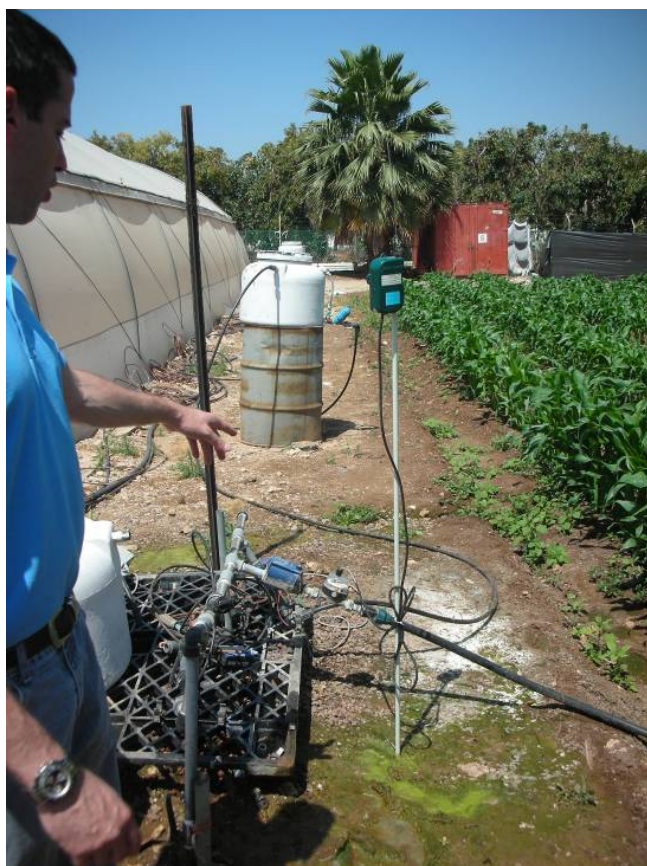
圖 53. 無線傳輸流量計安裝實務
