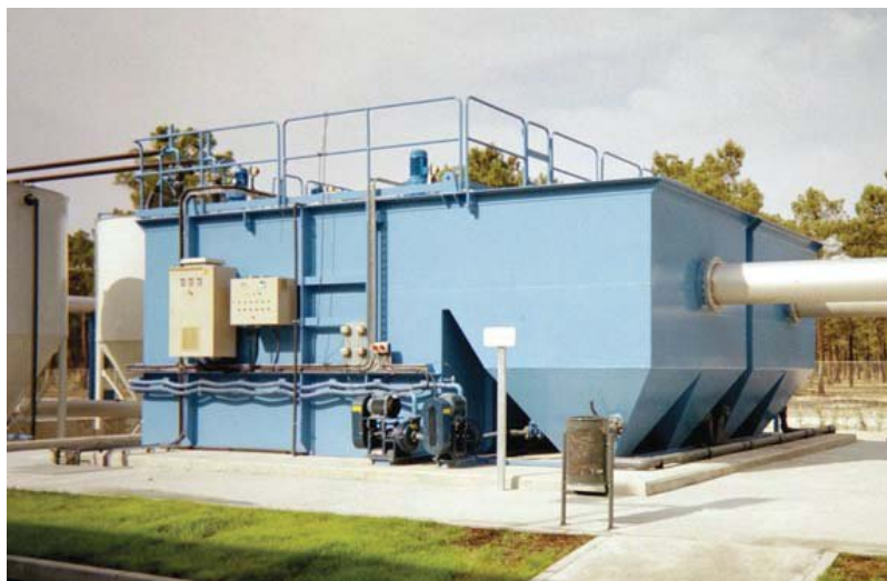
(2) Actiflo™ Pack Plant:設備
