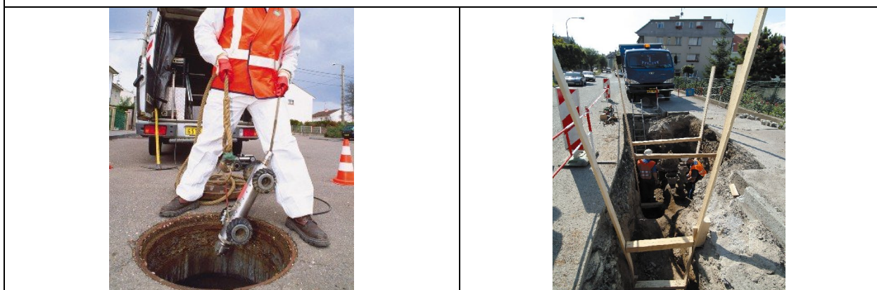
(9) 永久性排水網路診斷系統 (Permanent drainage network diagnostic tool) 運用 DIAGRAP® 結合 CCTV 進行排水網路診斷是否汰舊換新
