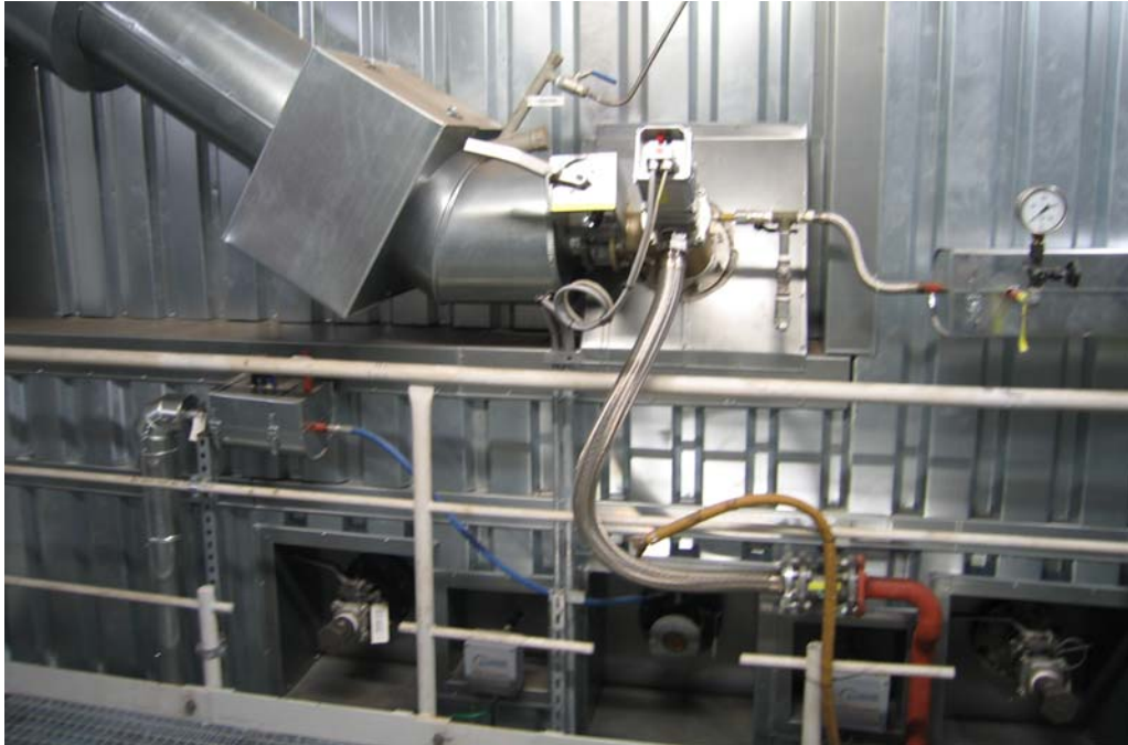
圖 20、鍋爐監測攝影機及監測孔
