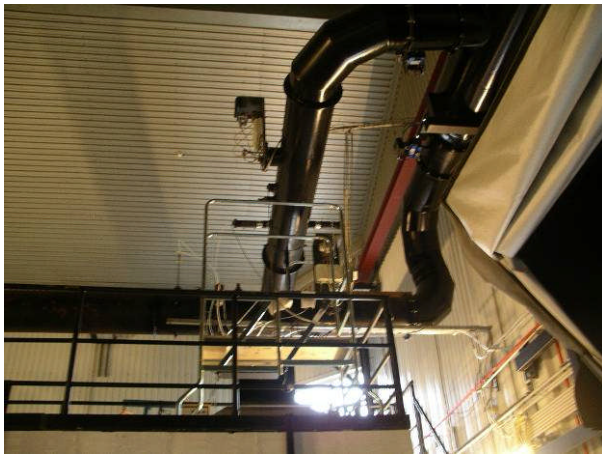
圖 10. 實驗排煙管路、煙氣採樣及濃度分析儀器
