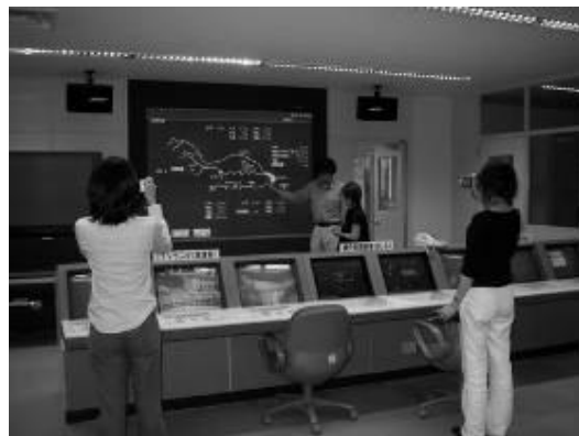
↑ 品木水庫水質管理所監控室
