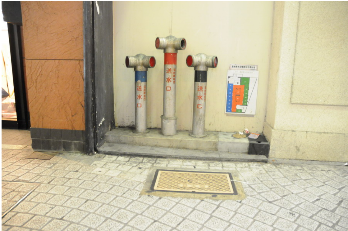
圖 4 消防栓設置於街道轉角處（金鐸市街道）
