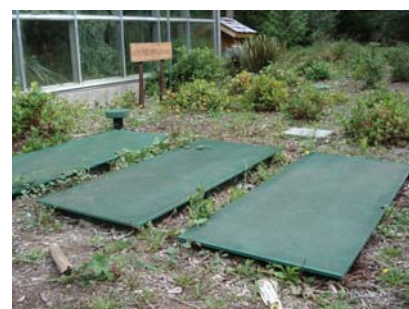
埋設於植物淨化廠外進行生菌分解的過濾槽
