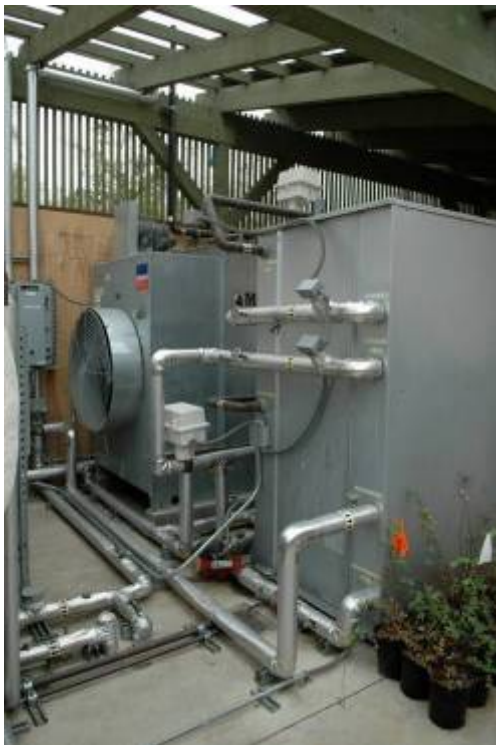
圖 84 空調系統吸收式冷凍主機
