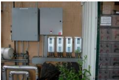
圖 86 太陽光電發電系統電力轉換裝置
