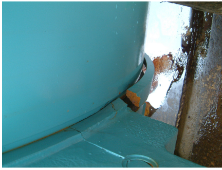
圖 9. GE 風力機齒輪箱損壞情形 1
