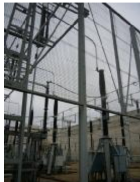
016 變電所設施配置 2
