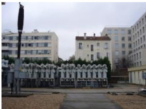
023 氣封電纜終端配置 1
