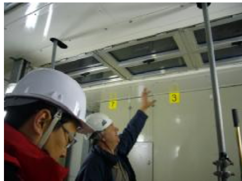
030 控制線槽下方透明隔板
