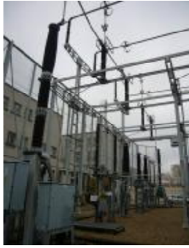
017 變電所設施配置 3
