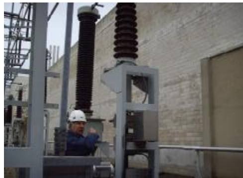
022 屋外電纜終端配置 3
