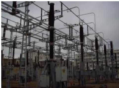
015 變電所設施配置 1
