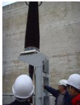
020 屋外電纜終端配置 1
