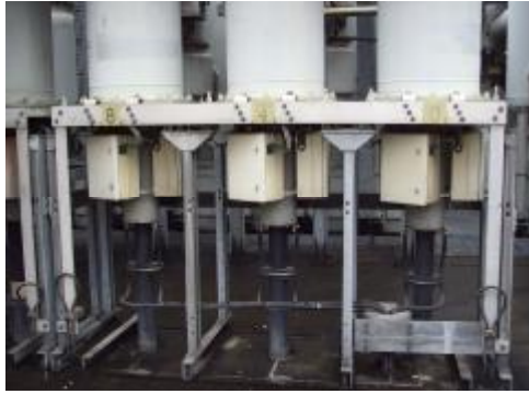
025 氣封電纜終端配置 3
