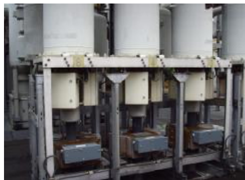
024 氣封電纜終端配置 2
