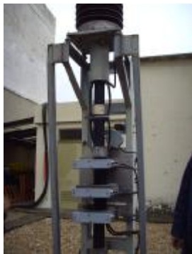
021 屋外電纜終端配置 2
