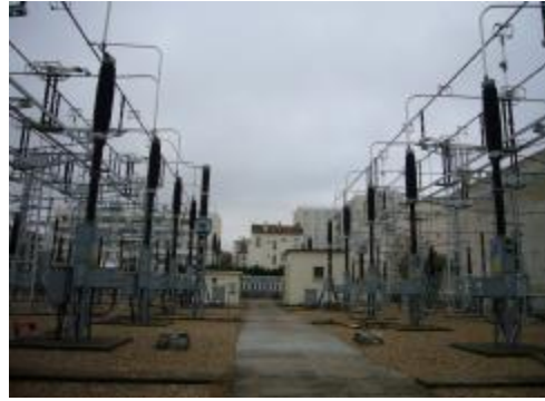
018 變電所設施配置 4
