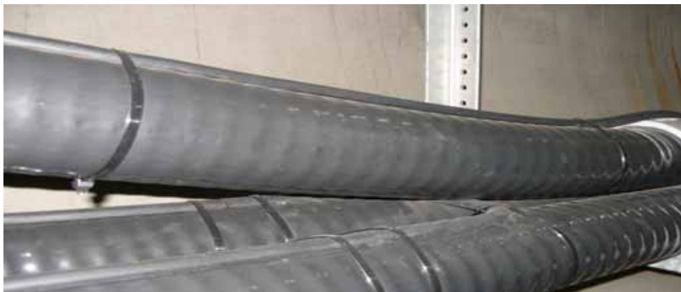
圖 12 接續匣處則每條電纜表面皆有裝光纖
