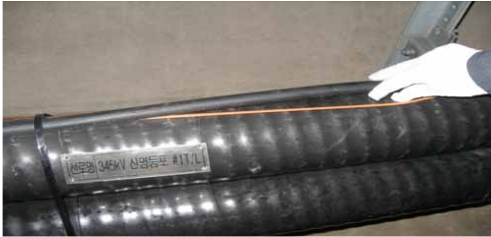
圖 11 光纖裝設於最上層電纜表面並由塑膠蓋住
