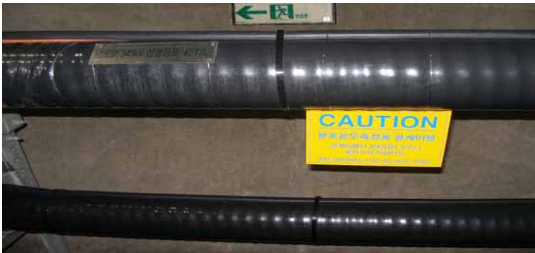
圖 7 電纜處接懸掛警示標誌及標示逃生標誌
