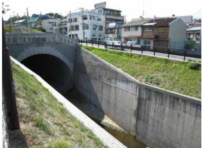
照片 4-9 大地震後「新湊川」的出口
