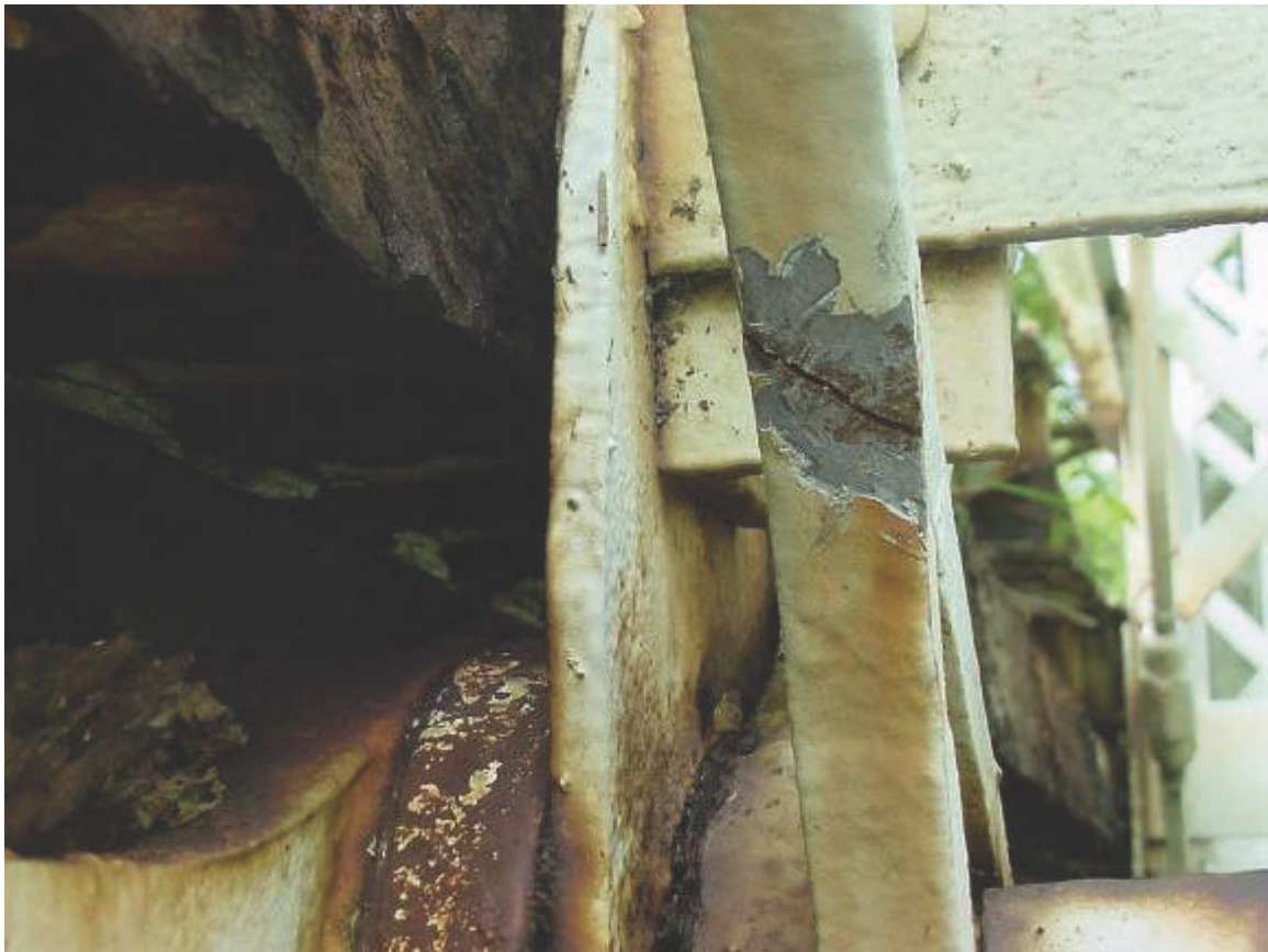
圖 2.9 桁架系統中桿件產生之裂縫
