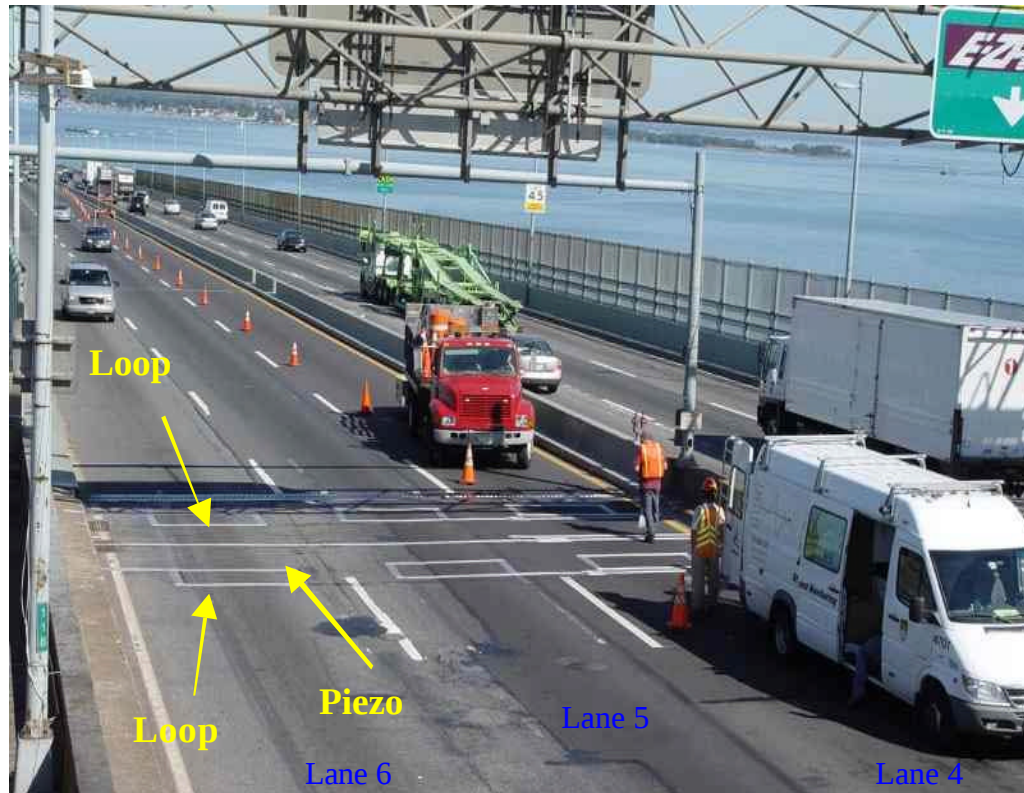
圖 2.1 WIM 感應器設置於橋面各車道
