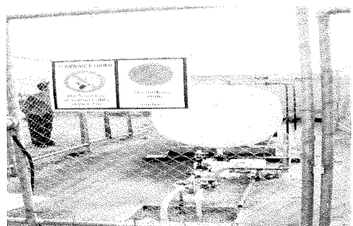
圖片 4：Caltex 加氣站 LPG 儲槽警示標語
