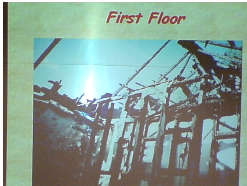
圖 6：現場燃燒十分嚴重，屋頂已燒穿。
