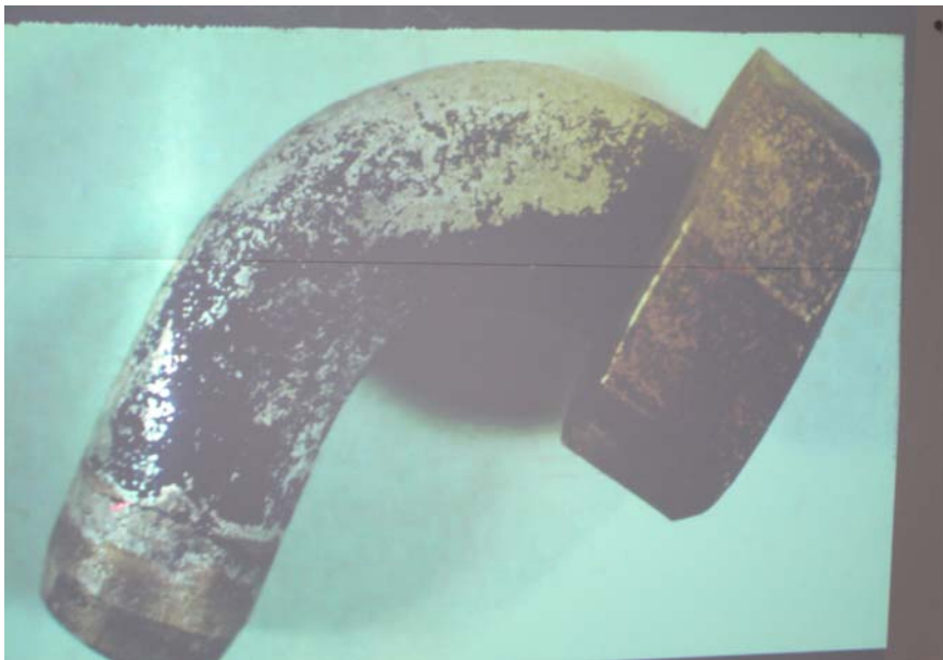
【相片 57】導管的脫落情形。
