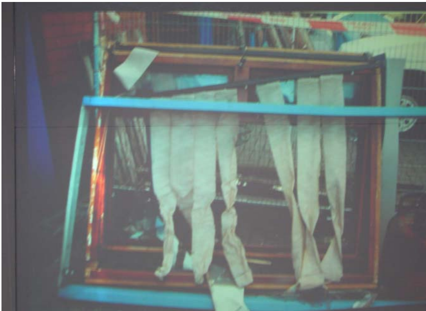
【相片 61】有部分窗戶是落地窗的窗簾，有些窗框仍然保持完整。如果這是瓦斯所引起的爆炸的話，應該是較空氣輕之甲烷或乙烷。
