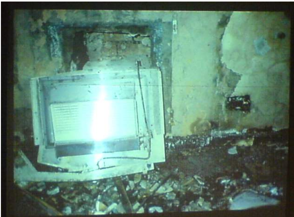
【照片 14】原先以為照片右方是起火點，並是一場意外，但是旁邊有一個瓦斯管，因為外洩的關係造成右方延燒嚴重。
