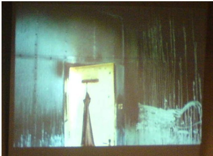
【照片 28】這個房間是有發現死者的房間，有人誤以為這是死者掙扎的結果，但全是消防人員留下的痕跡。還有救災產生水痕，英國消防人員稱為 smoke tears。
