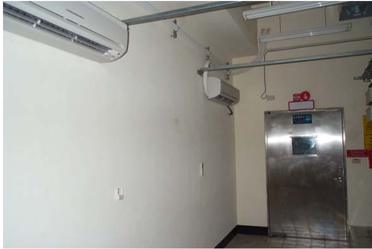
照片 6 豐華一次配電變電所分離式變頻空調
