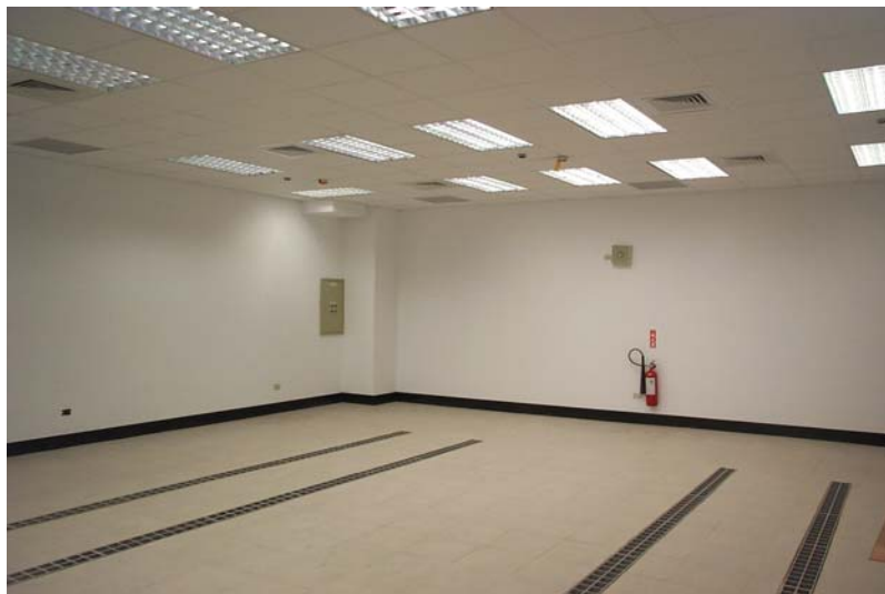
照片 7 路北一次配電變電所高效能照明燈具
