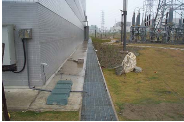
照片 3 豐華一次配電變電所雨水收集邊溝
