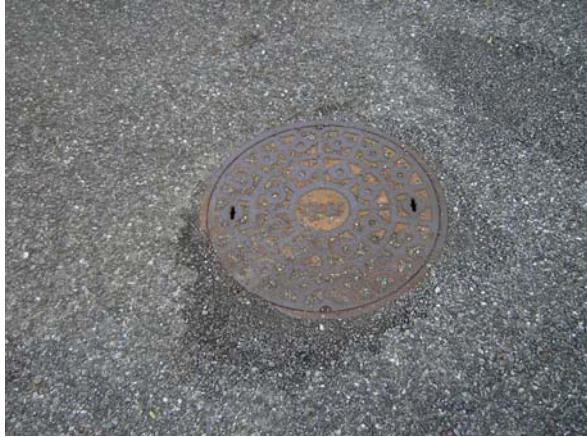
照片 17 污水排放系統
