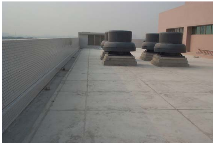
照片 5 柳營一次配電變電所屋頂隔熱及抽排風系統
