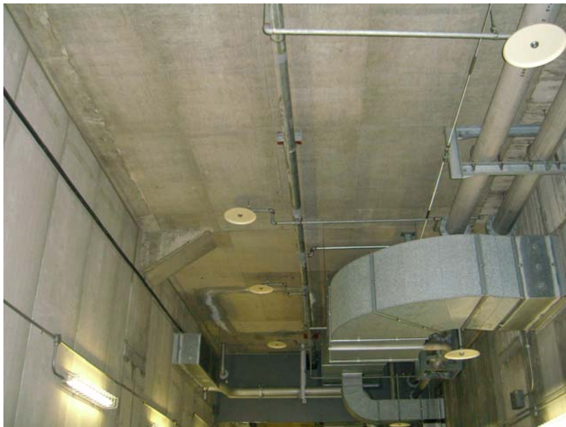
照片 10 日本變電所管路採明管佈設
