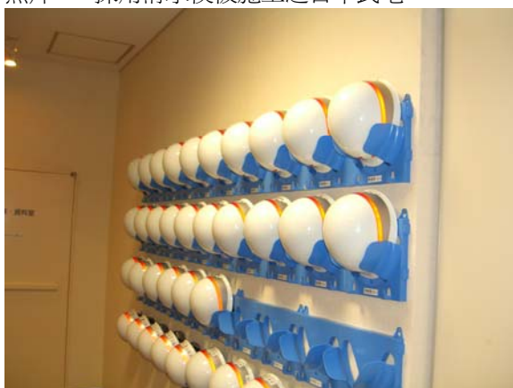
照片 24 整齊之安全帽收納架〈新豐洲變電所〉
