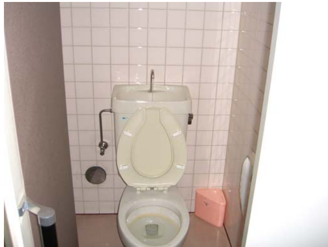
照片 15 日本變電所裝設省水型馬桶
