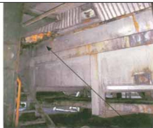
底灰槽積滿灰渣，撞破爐底斜斗
