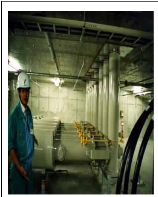
圖 19【A】中央變電所電纜整理室
