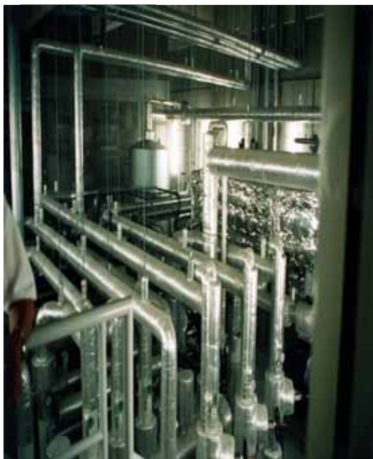
圖 13【A】中央變電所懸掛式冷卻水管
