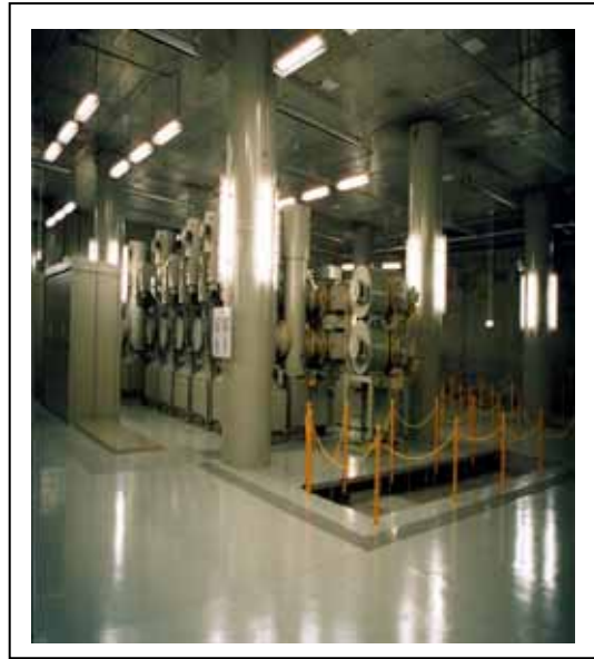
圖 18【A】中央變電所預留未來空間
