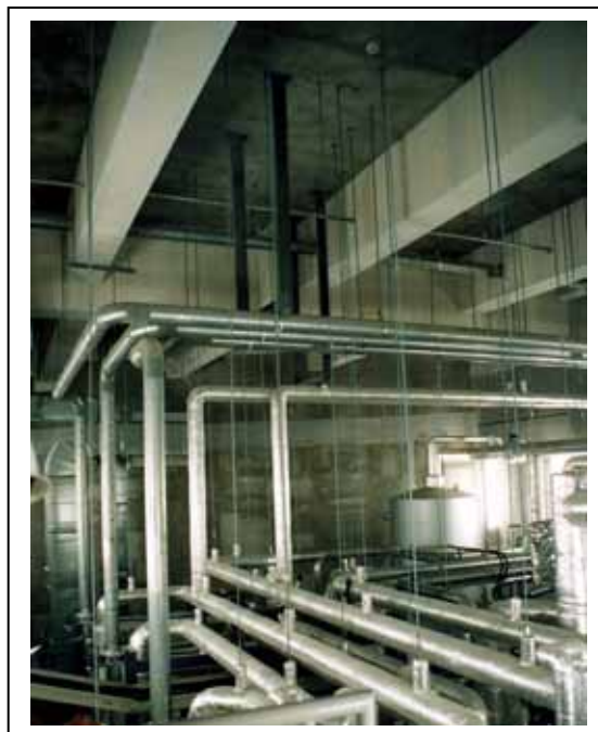
圖 14【A】中央變電所懸掛式冷卻水管
