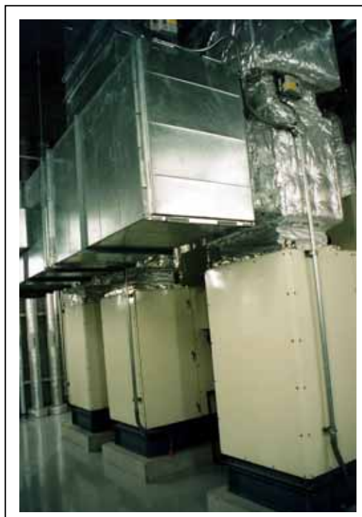
圖 16【A】中央變電所送風主機
