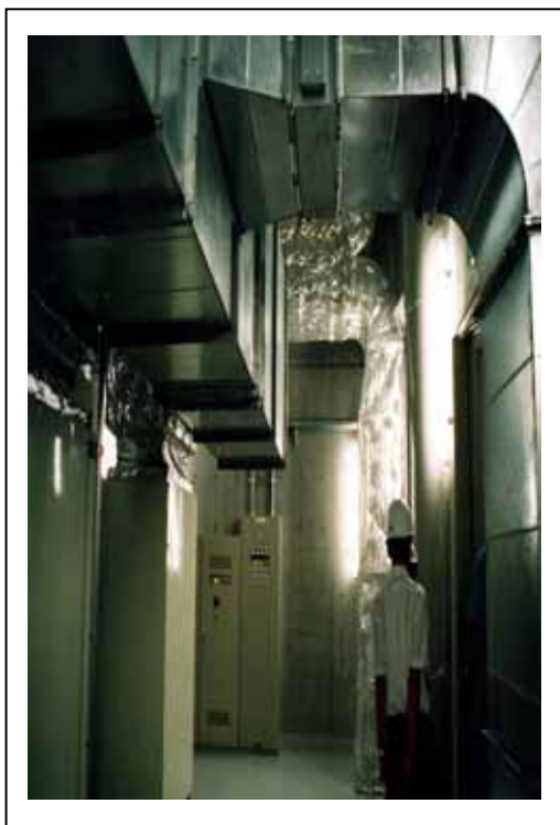
圖 15【A】中央變電所送風主機
