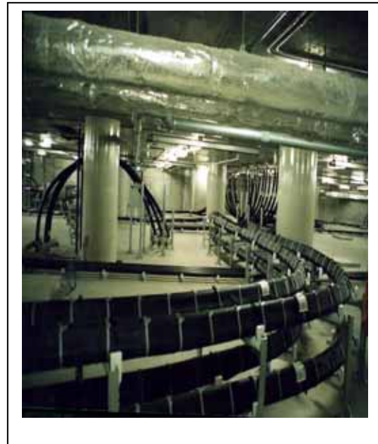
圖 20【A】中央變電所電纜整理室
