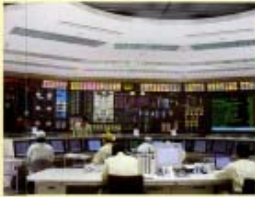
中央制御室（系統試験の様子）
