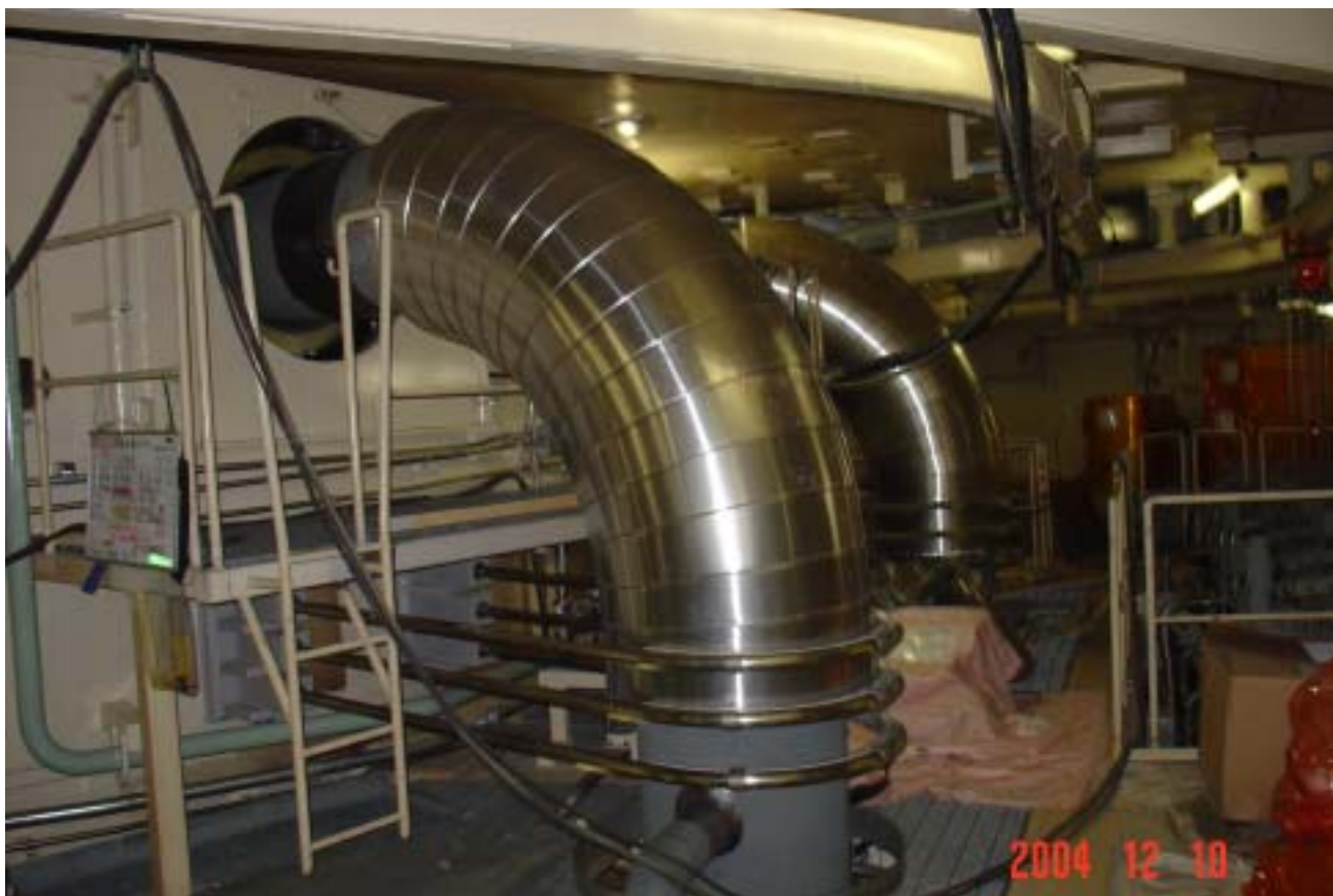
參觀志賀核能電廠 2 號機 RPV 主蒸氣管等設備一景
