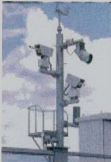
<写真>瀬戸大橋パンフ「気象観測装置」
