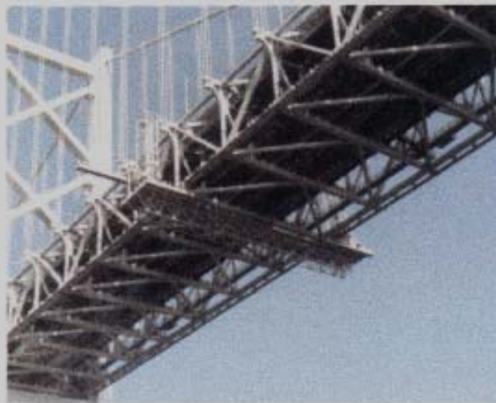
【桁外面作業車】
